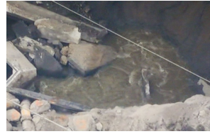
図-4 八潮市陥没箇所での湧水
