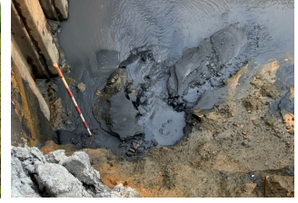
図-3 橋梁基礎掘削時の湧水
