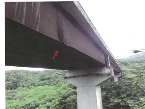
写真-8 P1~P2 橋脚間の桁の座屈変形
