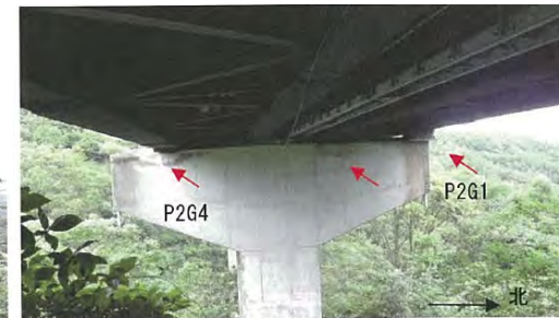
写真-7 橋桁の北側への相対移動と支承の損傷 (P2 橋脚)
