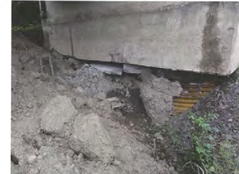
写真-13 熊本側橋台基礎前面の崩壊
