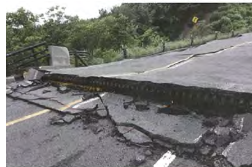
写真-4 南阿蘇側桁の伸縮継手の乗り上げ
