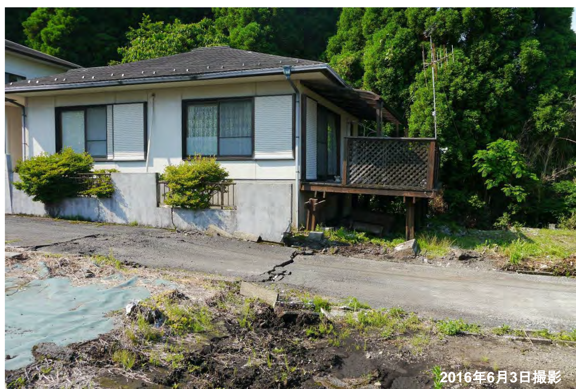
狩尾地区の黒川右岸の沖積錐斜面の押出しによる家屋の傾動
