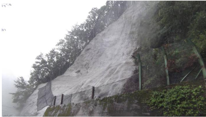
写真 3 上北山村白川地区崩壊地を望む
