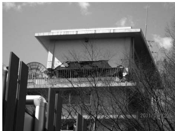
図9 仙台市の東北大学東北アジア研究センターの建物の損壊。
