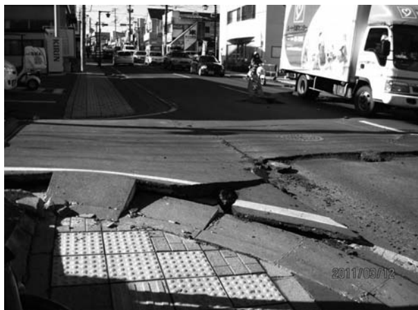
図8 仙台市の丘陵部における舗装道路の損壊。
