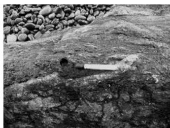
砂岩層が脆性的に破壊されている
